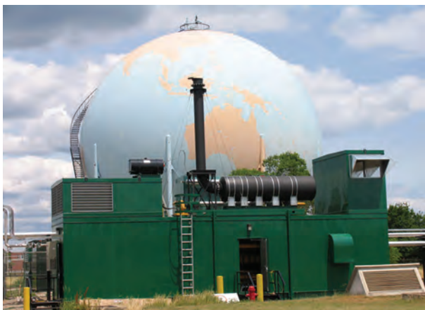
Рис. 3. Біогазова когенераційна установка фірми Hamilton Renewable Power (США) потужністю 1,6 МВт
