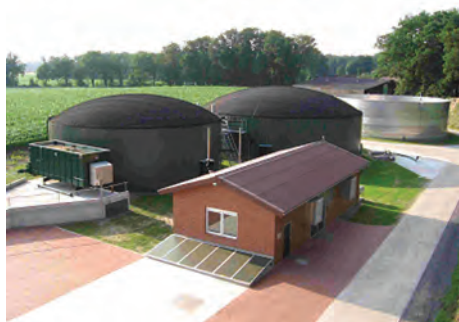
Рис. 8. Загальний вигляд установки Zorg
