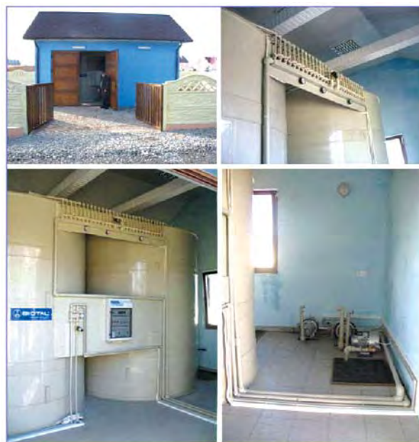
Рис. 8. Установка Biotal-50 (блочно-модульна наземна) в Чернівецькій області
